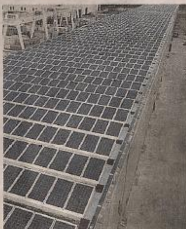
Tetti con pannelli fotovoltaici
